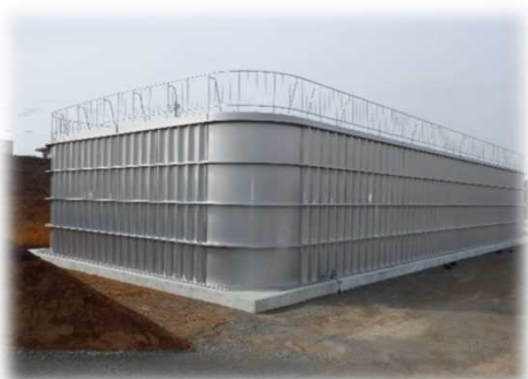
古房浄水場配水池（令和2年度更新）
