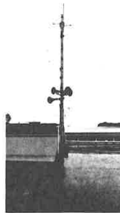
4 役場庁舎屋上に立つ観測の無線
