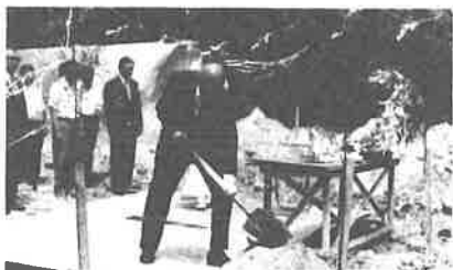
〈増田中学校舎起工式、くわ入れをする町長〉 増田中学校の校舎は老朽化にともない新築をすることになり、8月11日着工した。鉄筋コンクリート2階建 面積778㎡ 総事業費7,415万円
